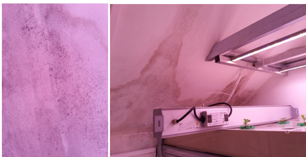
Podmáčený sádrokarton zasažený plísněmi (a). Instalace Dezinfekčního světla 405nm 1m od stěny.
